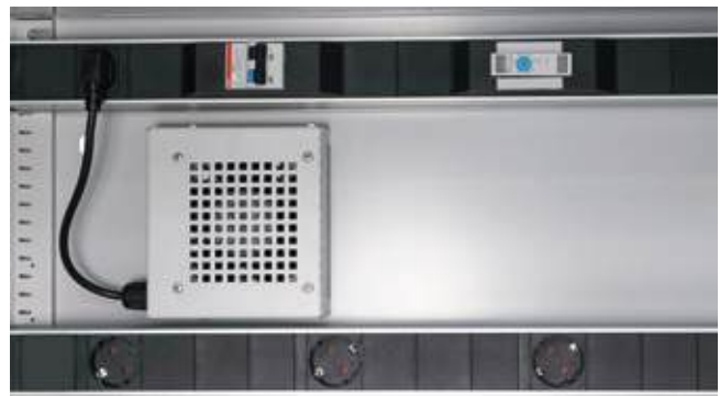
Temperaturgesteuerter Lüfter und Zentrale Masterleiste beim Comfort-Schrank
